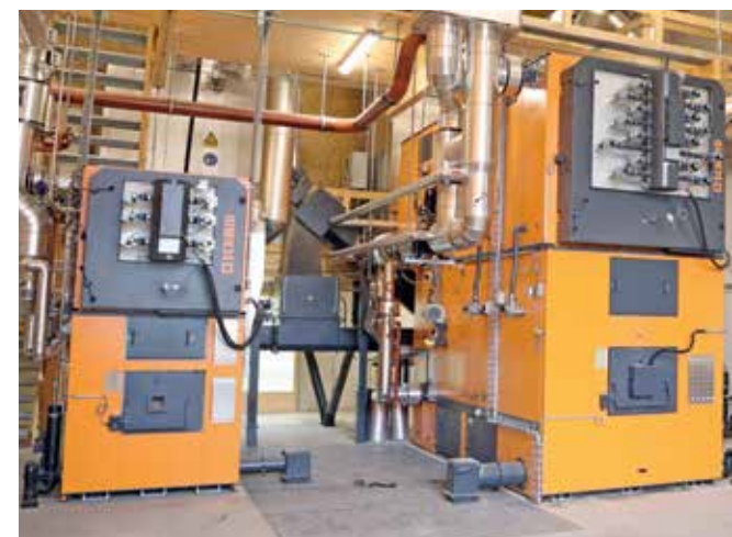
Cottura a griglia mobile Schmid Caldaia 1: UTSR-1600.32-1 visio / Caldaia 2: UTSR-550.32-1 visio
