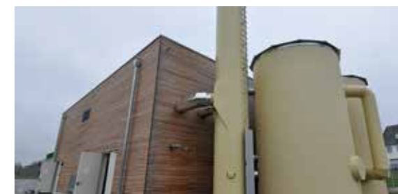
Das Heizwerk mit den beiden Pufferspeichern à je 60'000 Liter liegt genau zwischen den beiden Dörfern Neuerkirch und Külz.
